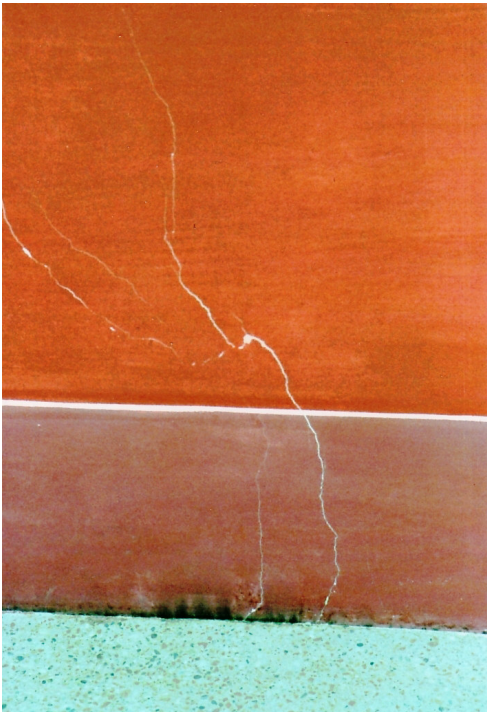
Abb. 4: Durch die Estrichdehnung nach außen gedrückte Wand, dadurch Risse und Eintritt von Ruß und Rauchgasen aus dem hypokaust in den Raum, AP Carnuntum, Villa Urbana. – The wall has been pressed outwards and has partially torn. Due to this, soot and flue gas were able to escape from the hypocaust.
