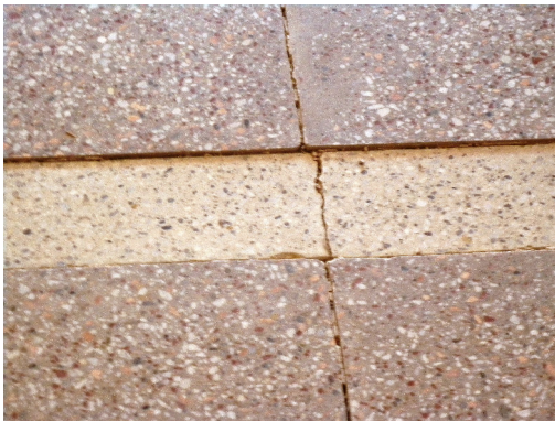
Abb. 3: Risse im Boden der basilika thermarum im Archäologischen Park von Carnuntum. – Clefts in the floor of basilica thermarum (Archaeological park Carnuntum).
