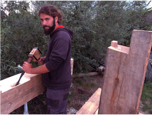
Abb. 7: An den oberen Enden der Eichenpfosten wurden die Auflagen für die quer liegenden Pfetten mit leichtem Gefälle nach innen hin gestaltet. Die Eckpfosten wurden zusätzlich mit Sichtzapfen gesichert. Die Arbeiten dafür erfolgten vor allem mit einem schweren Tüllenmeißel. – On the upper ends of the oak posts we formed sloping notches for the horizontal beams. The edge posts were additionally fixed by tenons. The work was carried out mostly with big socketed chisels.
