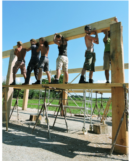
Abb. 8: Sechs Personen waren notwendig, um ein Pfettensegment in die Lagerfugen hochzustemmen. An den breitesten Stellen überbrücken die Pfetten derart bis zu vier Meter Distanz zwischen den Pfostenstellungen. – Six persons were necessary to lift up the segments of the wall plates to their positions. The wall plates bridged gaps of up to four meters in between the earthfast posts.
