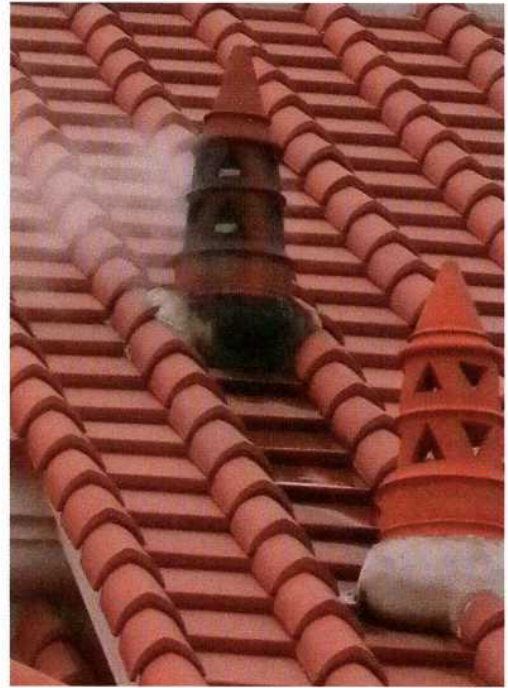
Abb. 13: Schwarze Versottungen an der Außenseite eines der Abzüge des Tepidariums gegen Ende des Heizversuchs; der saubere Abzug rechts gehört zur unbeheizten Schauanlage. – Black soots on the outside of a flue of the tepidarium near the end of the heating experiment; the clean flue on the right side belongs to an unused flue.
