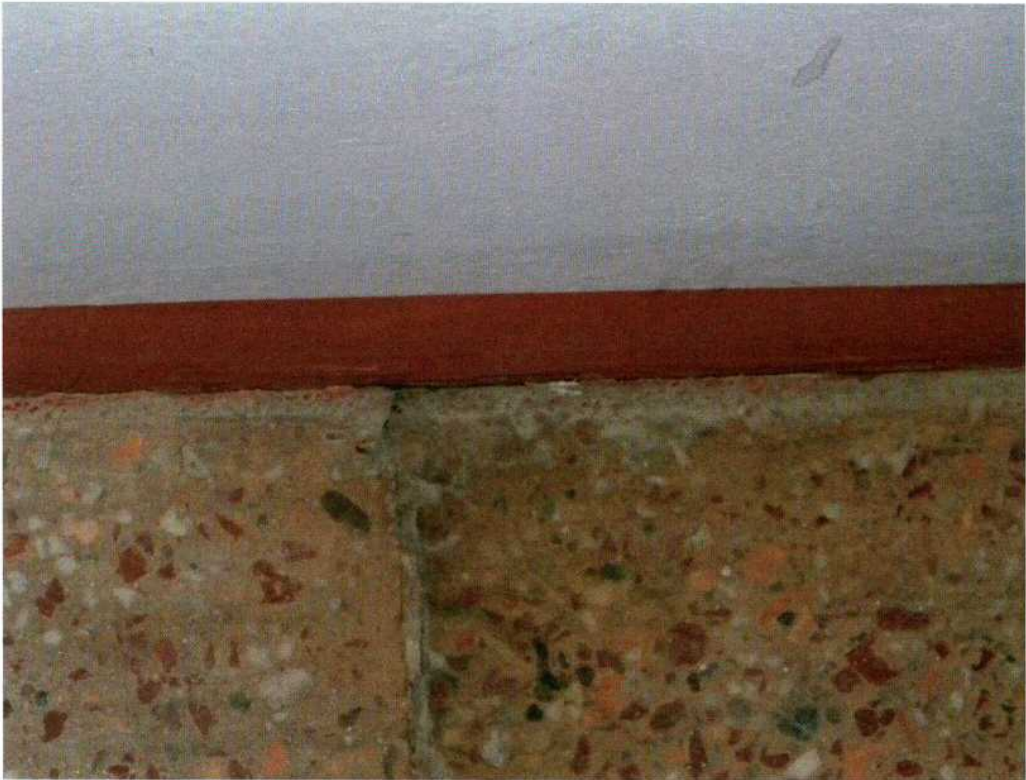
Abb. 11: Riss im Boden des Tepidariums mit für Rauchgas typischer bräunlicher Verfärbung. – Cleft in the floor of the tepidarium and brown discolouration by flue gas.
