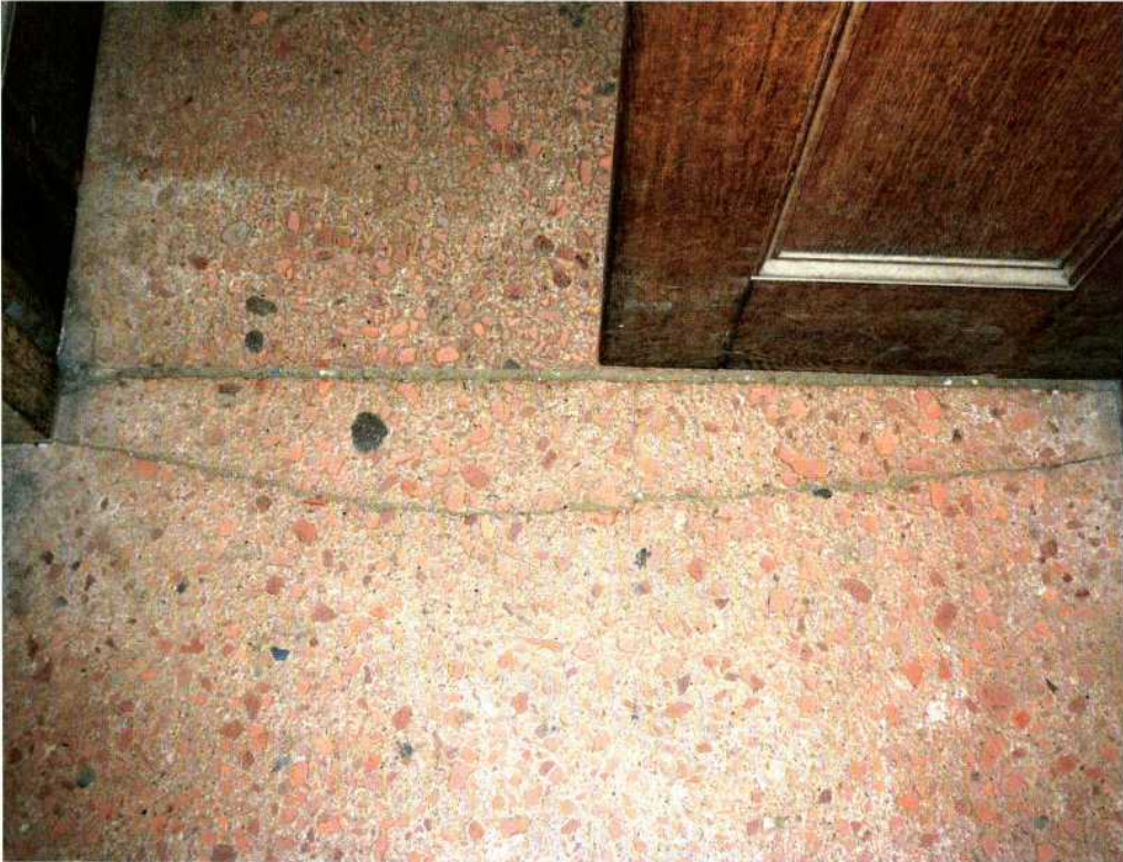
Abb. 6: Spannungsriss im Estrich (trotz einer, allerdings fest verschlossenen, neuzeitlich geplanten Fuge im Türbereich), AP Xanten, Herbergsthermen. – Crack formation (in spite of a modern, tightly closed, interstice in the door area); AP Xanten, Herbergsthermen.
