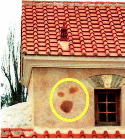
Abb. 12: Kondensatflecke (Versottung) an der Ostseite des „Apsisraums“ der Villa Urbana, AP Carnuntum. – Condensate stains (sooting) at the east wall of the „Apsisraum“ of the Villa Urbana, AP Carnuntum.
