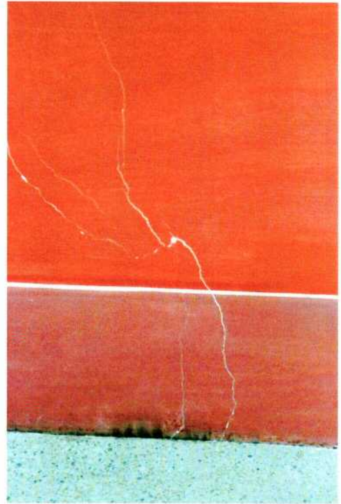
Abb. 7: Durch die Estrichdehnung nach außen gedrückte Wand, dadurch Risse und Eintritt von Ruß und Rauchgasen aus dem Hypokaust in den Raum, AP Carnuntum, Villa Urbana. – The wall has been pressed outwards and has partially torn. Due to this, soot and flue gas were able to escape from the hypocaust, AP Carnuntum, Villa Urbana.
