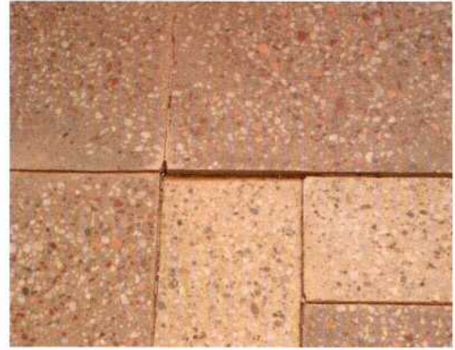
Abb. 10: Risse und Höhenversatz im Boden des Tepidariums. – Clefts and differences in level in the floor of the tepidarium.
